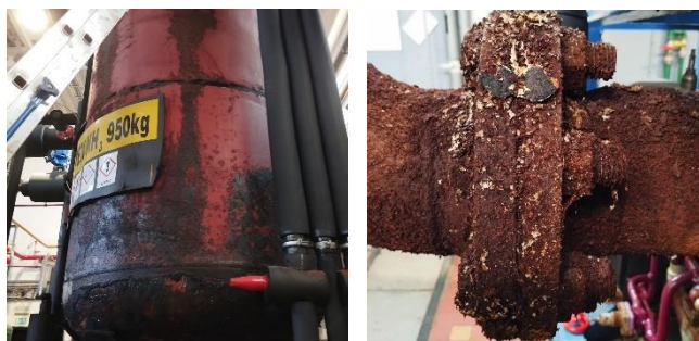
ZS - Opravy ve strojovně
